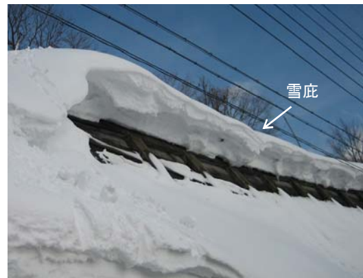
写真 2 法肩にせり出した雪庇
